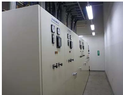
高圧盤製造、施工
