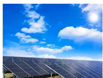
太陽光2019年問題対応 蓄電池設置
