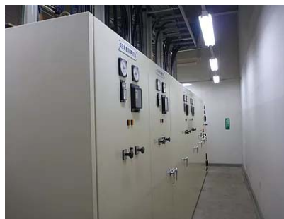
高圧盤製造、施工
